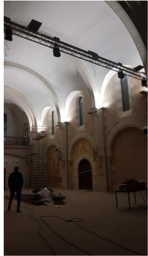
La poutrelle métallique servant de point de fixation pour les lumières, la sonorisation et une partie de l'éclairage.
